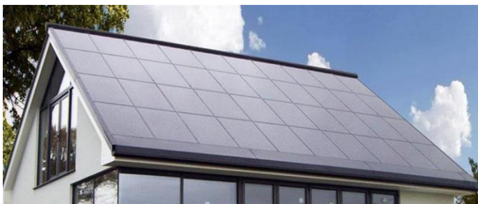
Katteeseen integroidut aurinkopaneelit (Kuva: Solarguide)
