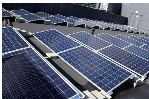
Aurinkopaneelit kauppakeskuksen katolla (Kuva: Yle)
